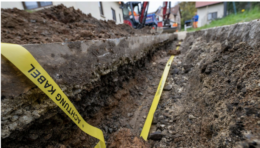
Bei Bauarbeiten in der Nähe von Braunschweig wurde ein Kabel beschädigt. (Symbolbild) Foto © Pia Bayer/dpa
