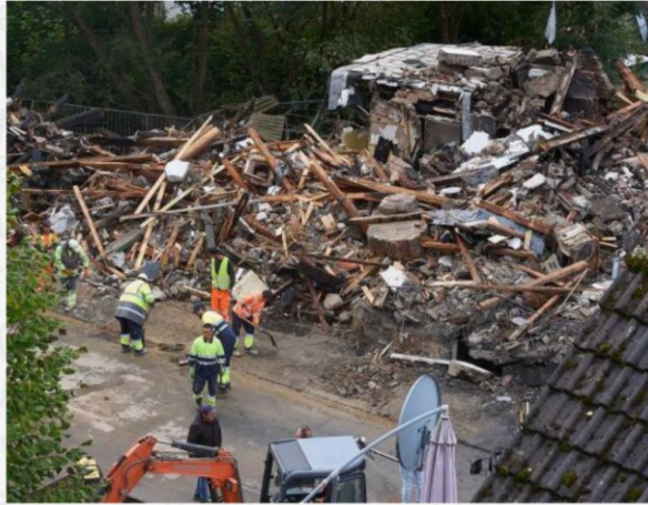
Durch die verheerende Gasexplosion in Daaden wurde ein Wohn- und Geschäftshaus völlig zerstört. Mehrere Menschen wurden bei dem Unglück verletzt, ein 15-jähriger Junge schwer.
