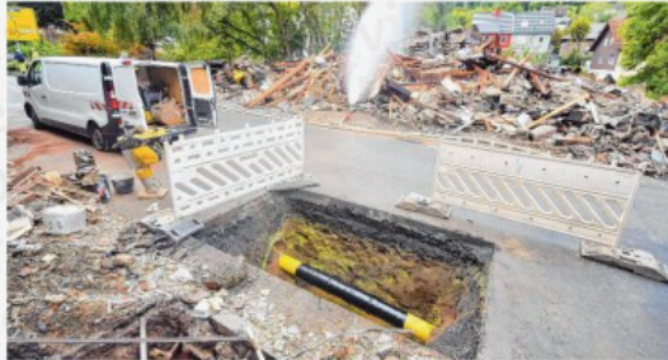
Ein Schaden an der Gasleitung hat die Explosion in Daaden verursacht. Das wirft Fragen auf: Wie sicher ist der Energieträger Gas?
